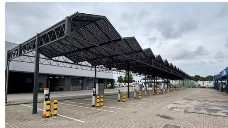
Het laadplein is uitgerust met een zonnecarport en een batterijopslagsysteem, waardoor de wagens 's nachts kunnen worden opgeladen met duurzame energie.
